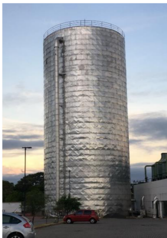
Figura 3.3 – Tanque de água gelada do objeto de estudo. Fonte: Autoria própria (2021).
