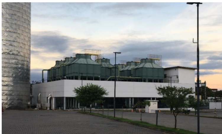
Figura 3.1 - Central de Água Gelada em estudo. Fonte: Autoria própria (2021).
