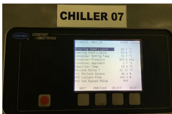
Figura 3.6 - Visor de monitoramento e controle do chiller . Fonte: Autoria própria (2021).
