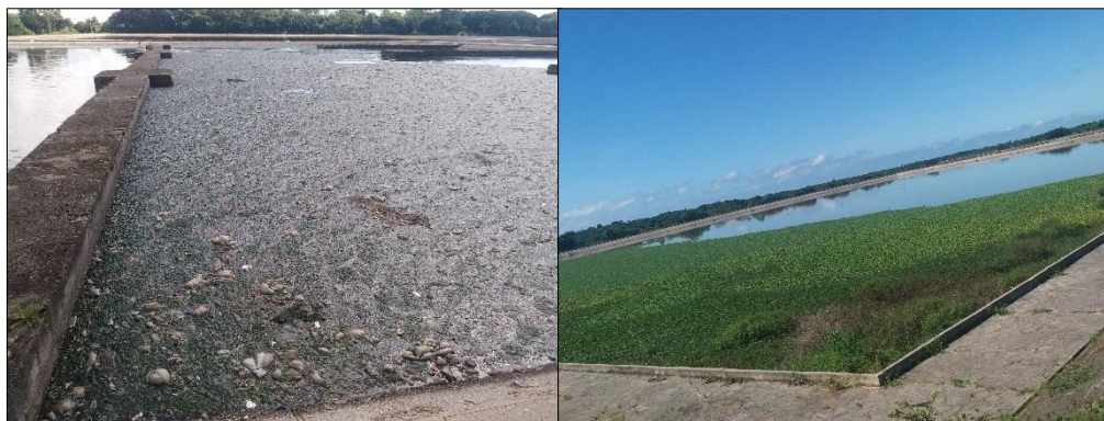
Figura 32 - Problemas na ETE de Mangabeira IV (a) presença de resíduos sólidos na lagoa anaeróbica e (b) proliferação de espécies primárias de plantas na superfície da lagoa facultativa
