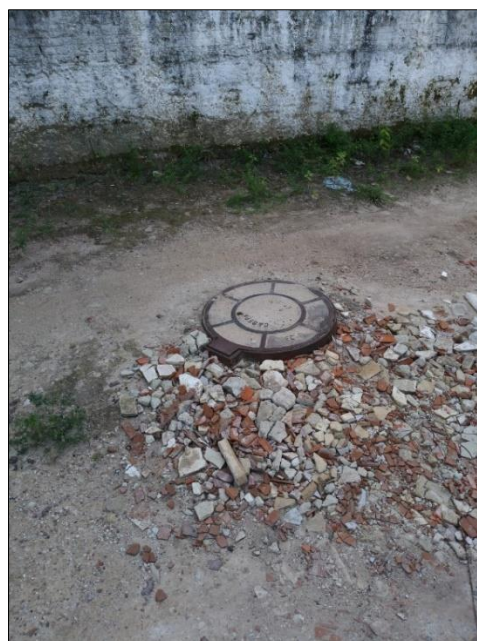
Figura 24 - Poço de visita de esgoto em um ponto da BHRC
