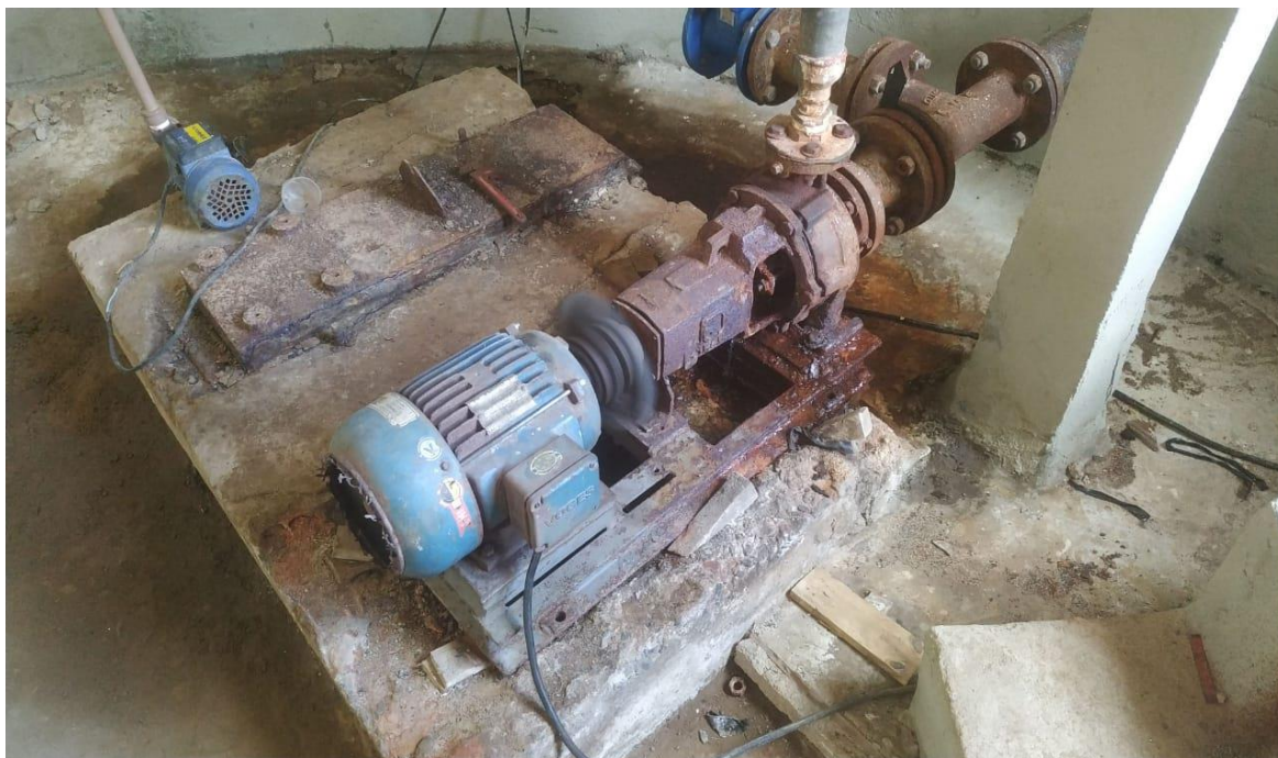
Figura 4.7 – Conjunto motobomba de 5 cv da EEAT3.
