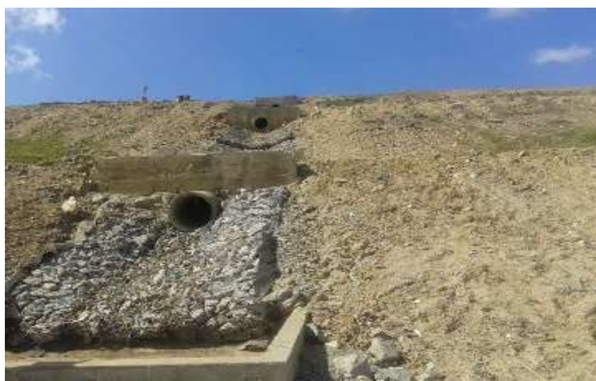
Figura 18 – Drenagem de água pluvial ou Berma no Aterro Sanitário ASMOC.
