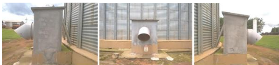
Figura 21. Renovadores de ar instalados na Unidade de Beneficiamento de Grãos. Fonte: autor.
