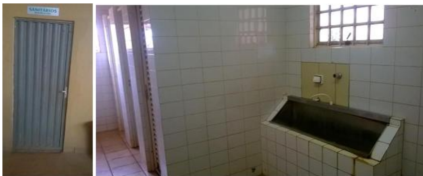
Figura 7. Instalações Sanitárias localizadas no interior da UBG. Fonte: autor
