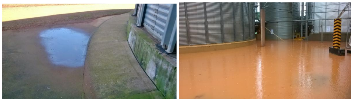
Figura 5. Não Conformidade em relação à drenagem na Sede I (direita) e Sede II (esquerda).
