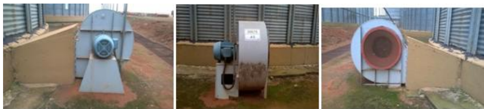
Figura 16. Sistema de aeração instalado na base dos silos de armazenamento. Fonte: autor.
