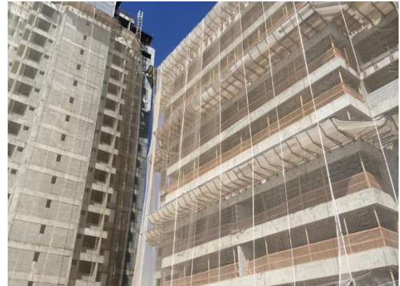
Figura 4 - Tela de proteção para fachada de prédio.
