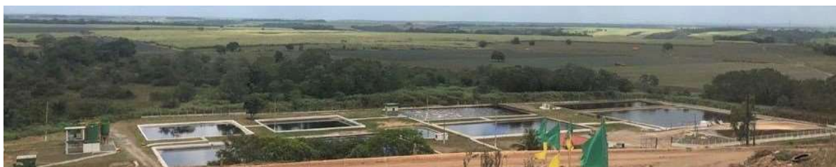
Figura 6 - Estação de tratamento de lixiviado do Aterro Sanitário Metropolitano de João Pessoa.
