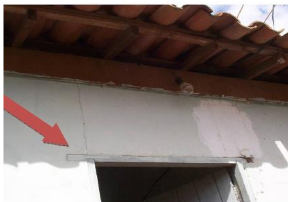
Figura 2.22 - Verga de madeira sem rigidez adequada
