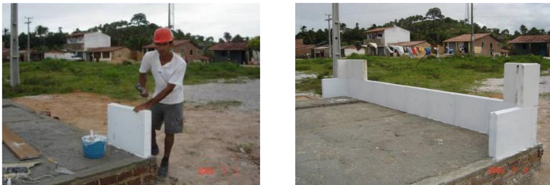
Figura 2.19 - Processo construtivo inadequado: bloco em contato direto com o piso
