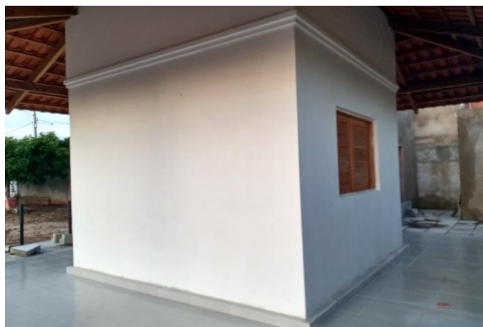
Figura A.36 - Parede rebocada
