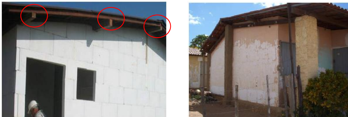
Figura 2.21 - Peças de madeira do telhado apoiando-se diretamente sobre os blocos de gesso e beirais muito curtos
