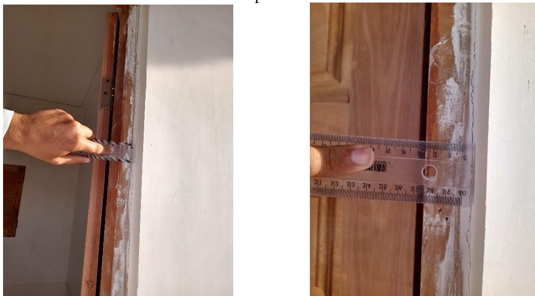
Figura 6.4 - Fissuras entre o marco e a parede após ensaio de fechamento brusco de porta
