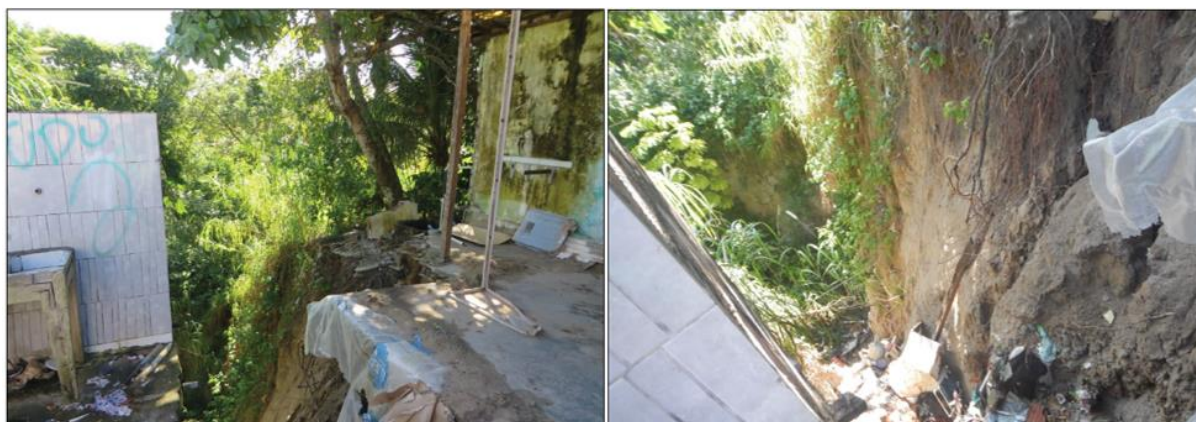
Figura 36 – Danos estruturais em residências no setor de muito alto risco SR 29, localizado no bairro de Valentina.
