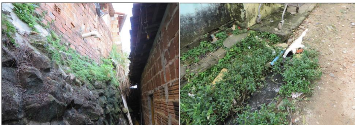
Figura 32 – Lançamento de águas servidas nos setores de muito alto risco SR 36, localizado no bairro de Miramar, e SR 45, localizado no bairro do Roger.
