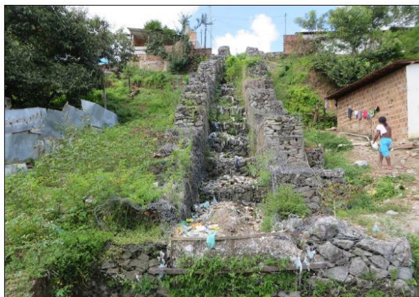
Figura 28 – Escadaria hidráulica no setor de muito alto risco SR 23, localizado no bairro do Varjão.
