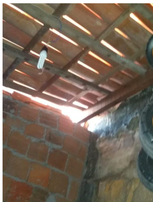
Figura 26-Paredes danificadas depois das demolições
