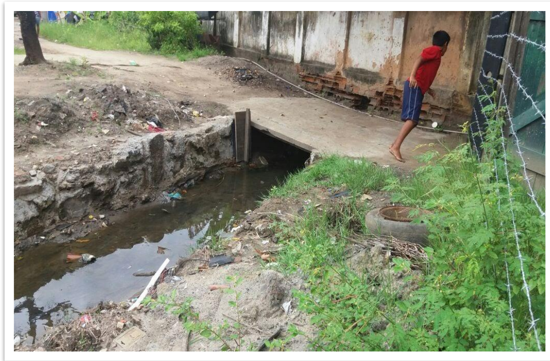
Figura 35- Águas Pluviais desviadas para dentro da comunidade na área da Vila Nassau
