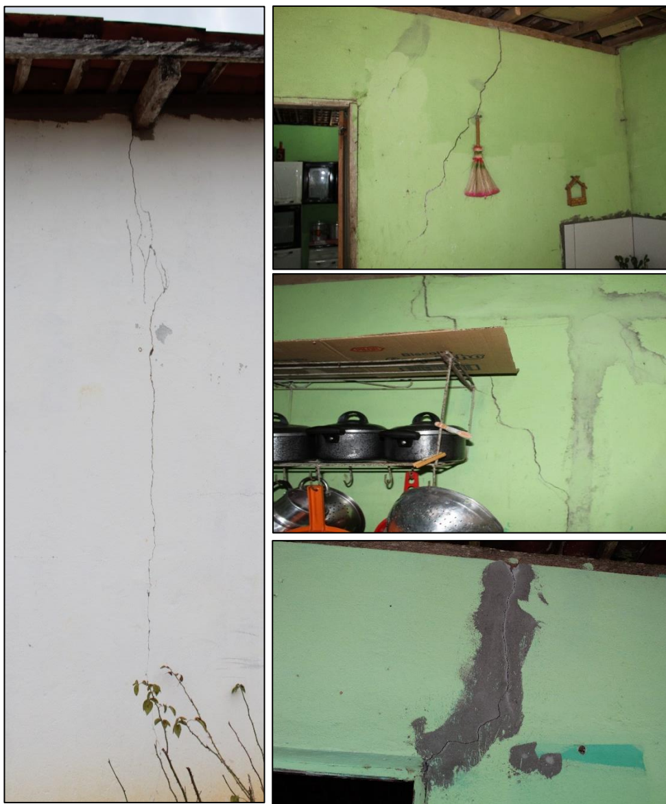
Figura 14 - Rachaduras presentes em uma residência próxima a mina de extração
