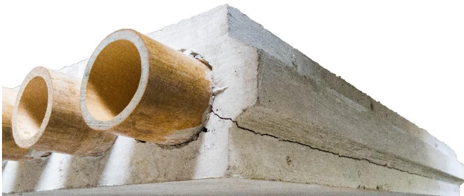
Figura 60: Fissura longitudinal em detalhe
