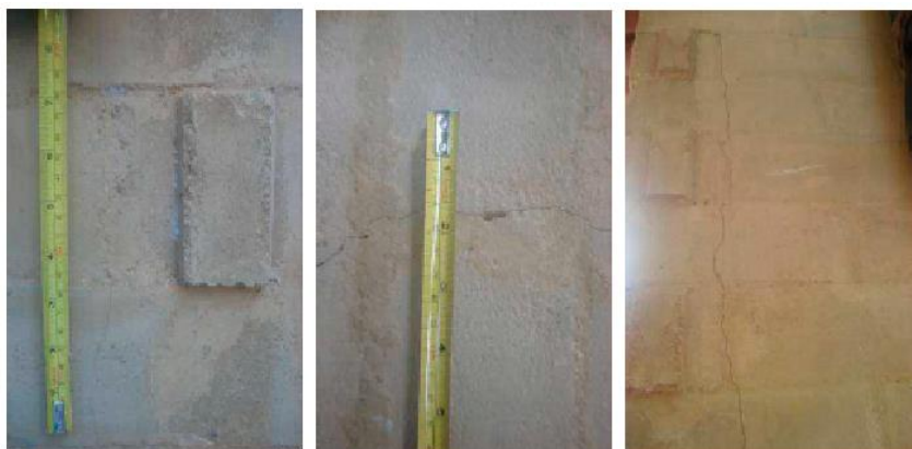
Figura 87: Fissuração da amarração dos blocos após ensaio de impacto de corpo mole
