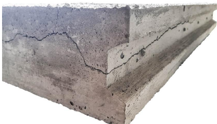
Figura 67: Detalhe na fissuração do Painel 2
