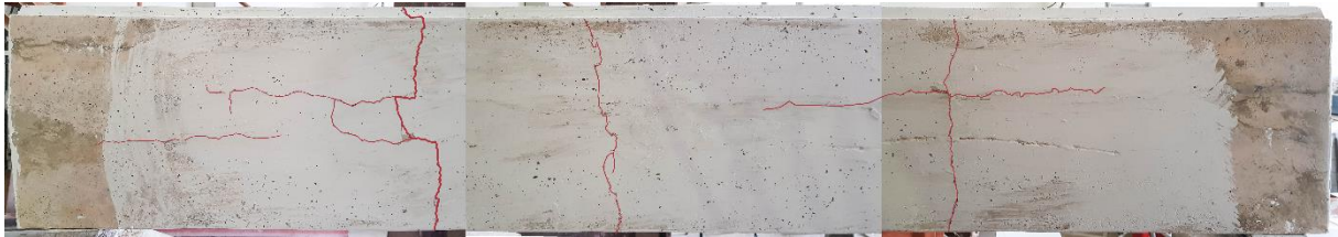
Figura 72: Painel fissurado após o ensaio de flexão
