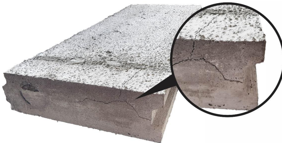
Figura 66: Detalhe da fissuração no Painel 2
