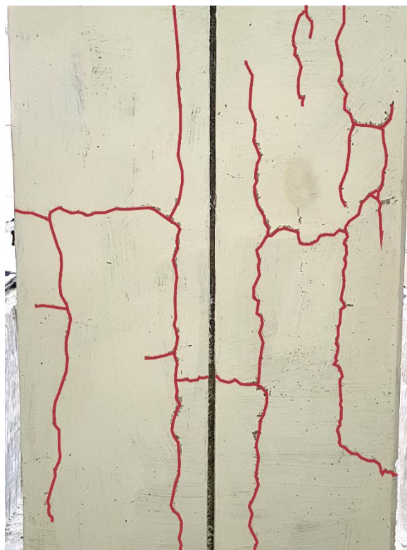
Figura 85: Fissuras apresentadas no Módulo 1
