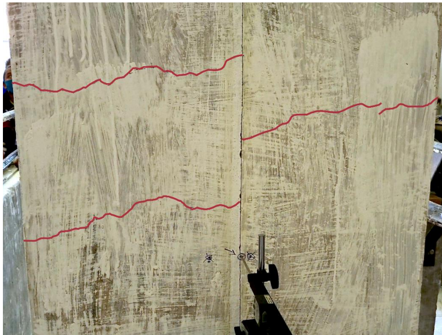
Figura 86: Fissuras apresentadas no Módulo 2
