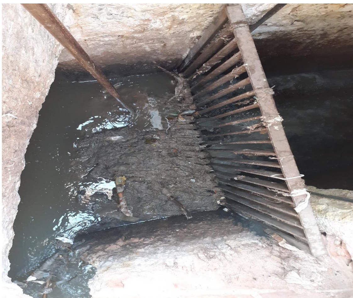
Foto 1 - Grade de Contenção de lixo Elevatória Beira Rio
