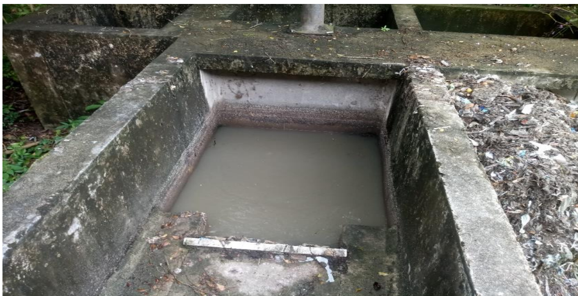
Foto – 9 Grade de Contenção de lixo
