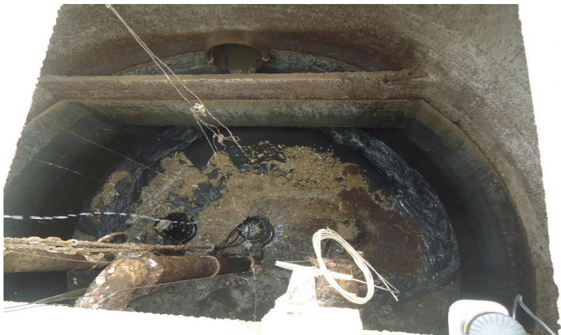
Foto 5 - Elevatória de Esgotos
