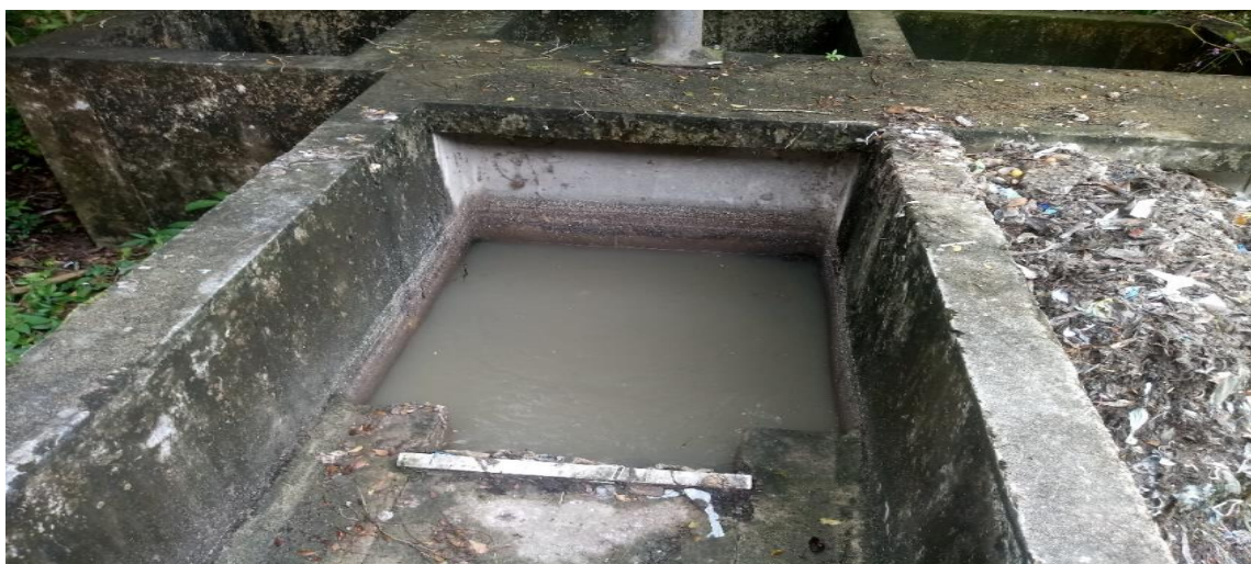
Foto 3 - Grade de contenção de lixo
