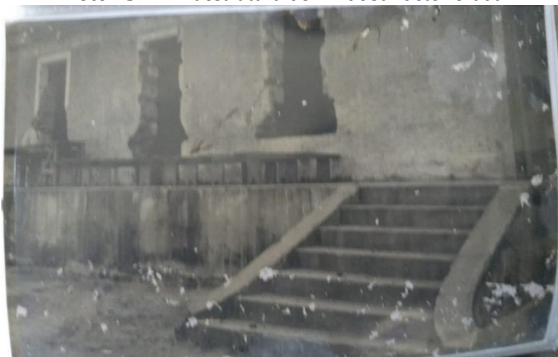
Foto 25 – Infraestrutura de Pindobal deteriorada
