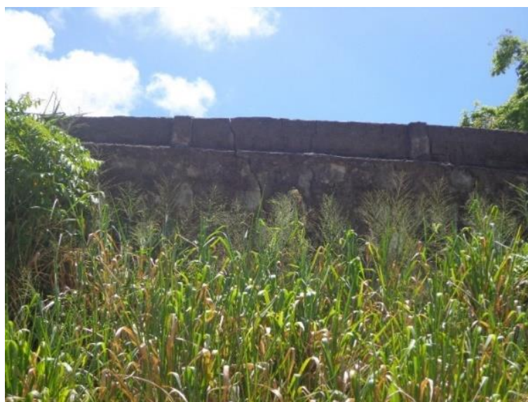
Figura 17 –Muro que limita o perímetro do Parque. Risco de queda devido deslizamento / escorregamento.
