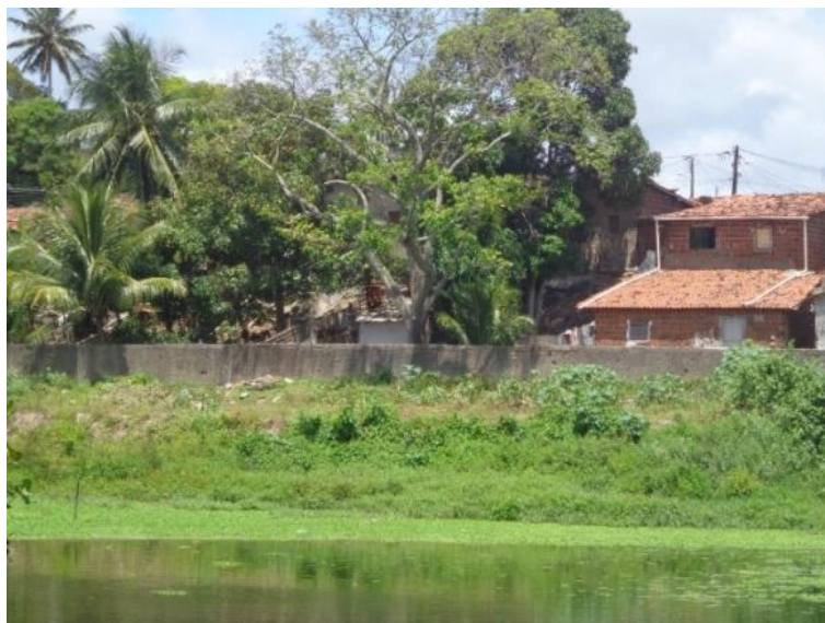
Figura 16 –Muro que limita o perímetro do Parque. Risco de queda devido deslizamento / escorregamento.
