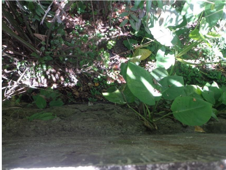
Figura 14 – Muro em declive. Risco de deslizamento / escorregamento.
