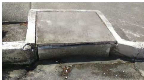
Figura 2 – Exemplo de obstrução em bocas de lobo
