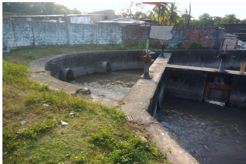
Figura 14: Esgoto chegando aos tanques de acumulação
