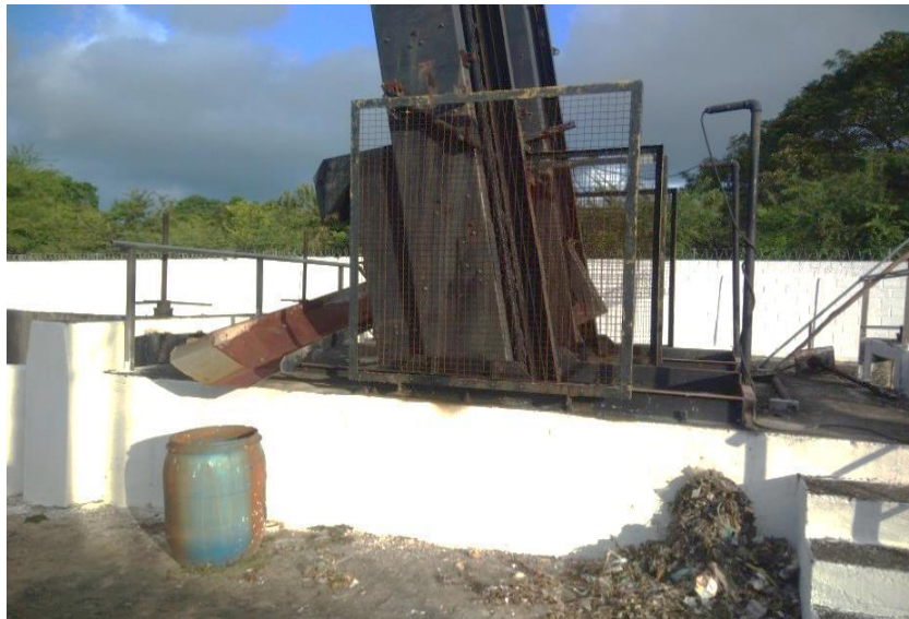
Figura 19: Material retirado manualmente da grade
