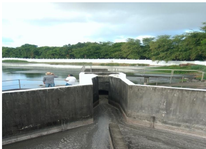
Figura 21: Calha Parshall na ETEBP
