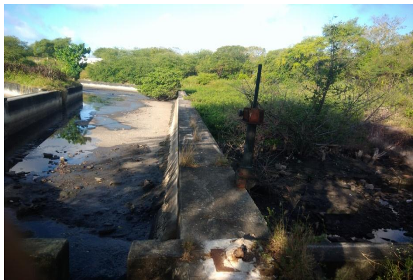
Figura 12: Tanques de descarga
