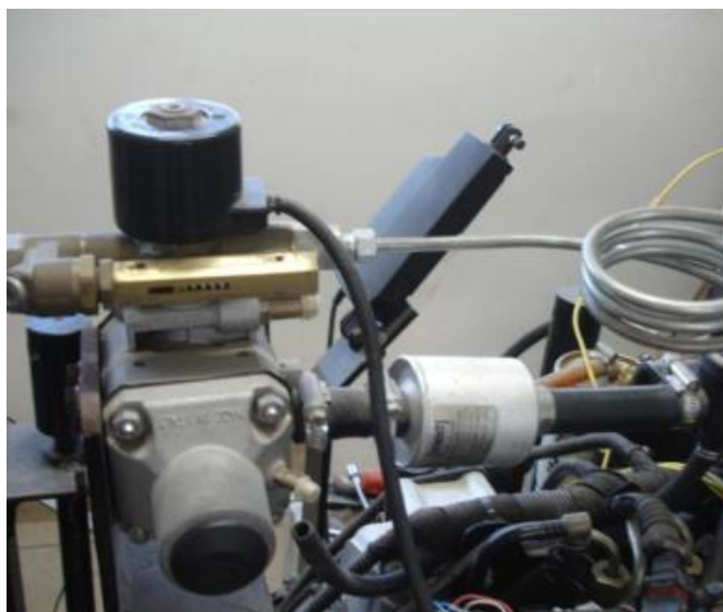
Figura 17 - Conjunto Redutor de Pressão e Filtro GNV Instalado no Motor MWM 4.07 TCE
