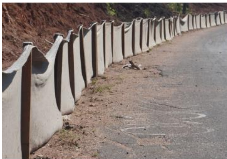
Figura 20: Detalhe da barreira retendo e não permitindo a passagem dos sedimentos.
