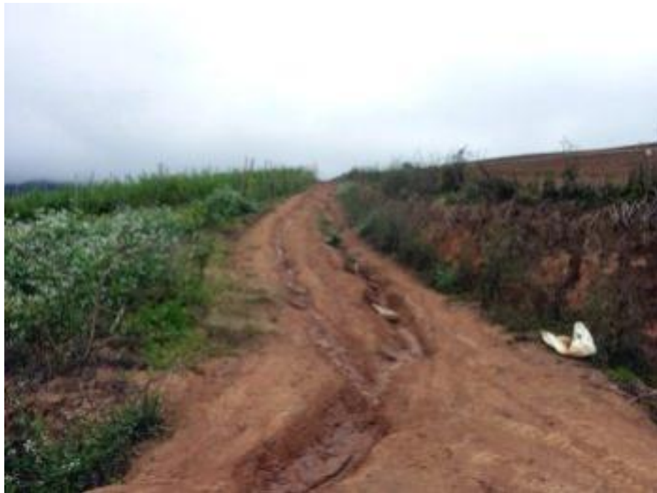
Figura 2: Formação de sulcos devido a erosão pluvial.
