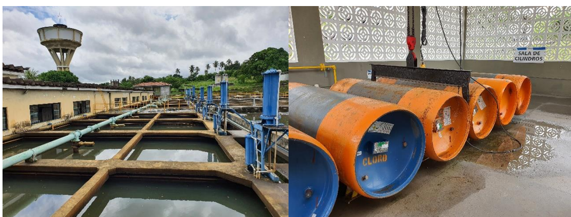
Figura 4 – Filtros (a) e Cilindros de cloro (b) da ETA de Marés.
