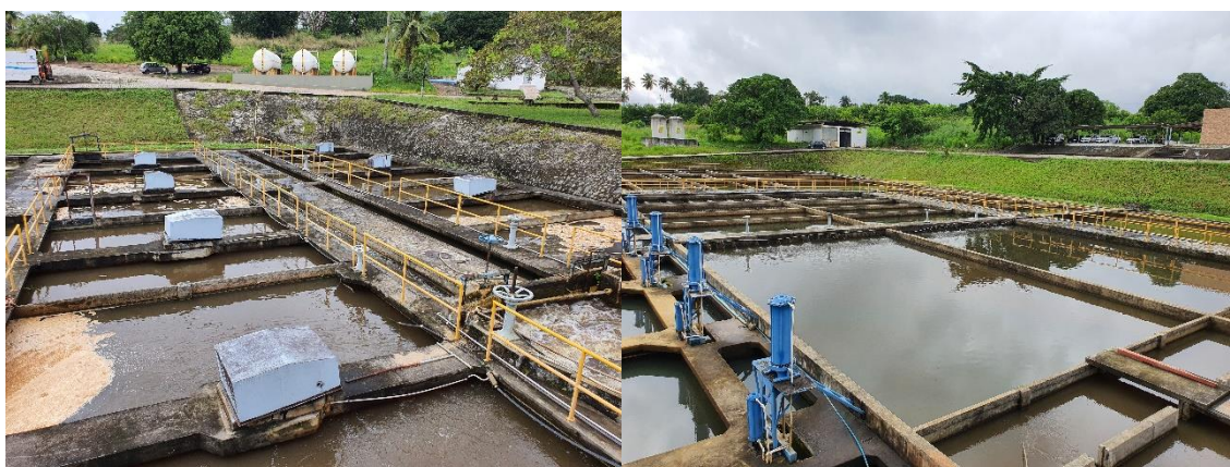
Figura 3 – Floculadores (a) e Decantadores (b) da ETA de Marés.
