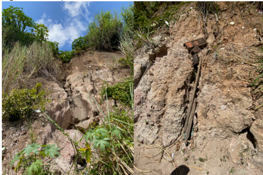
Figura 59 - Feições erosivas identificadas no talude da BR-230/PB
