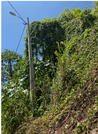
Figura 58 - Vegetação no talude da BR-230/PB
