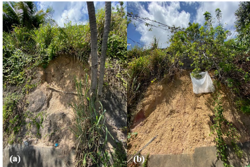
Figura 56 - Cicatrizes de deslizamento ao longo da rodovia BR-230/PB no bairro do Castelo Branco em João Pessoa-PB
