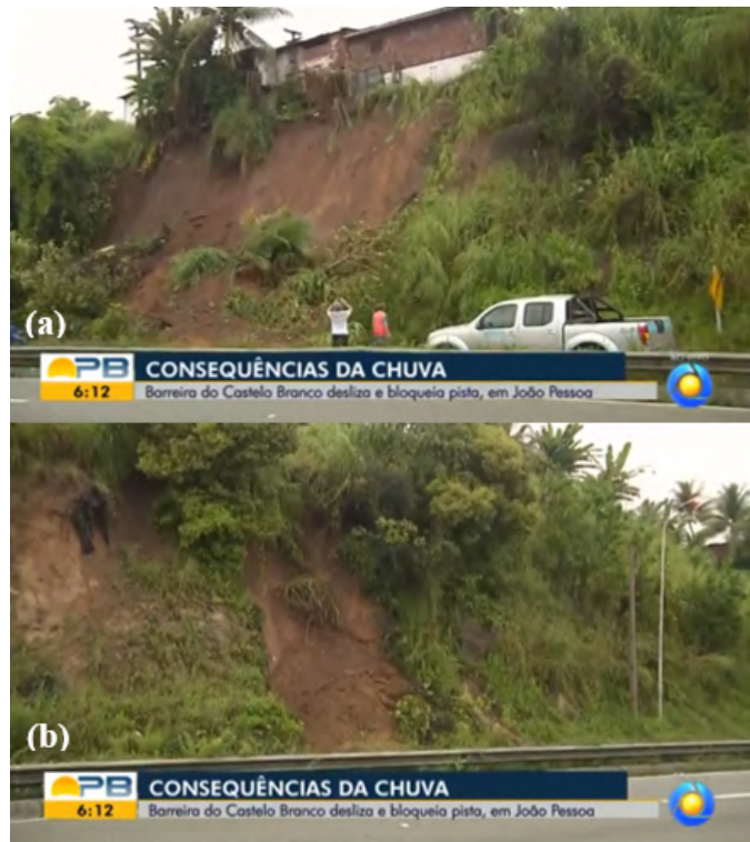
Figura 47 - Deslizamentos ocorridos no ano de 2019 em dois pontos da BR-230/PB
