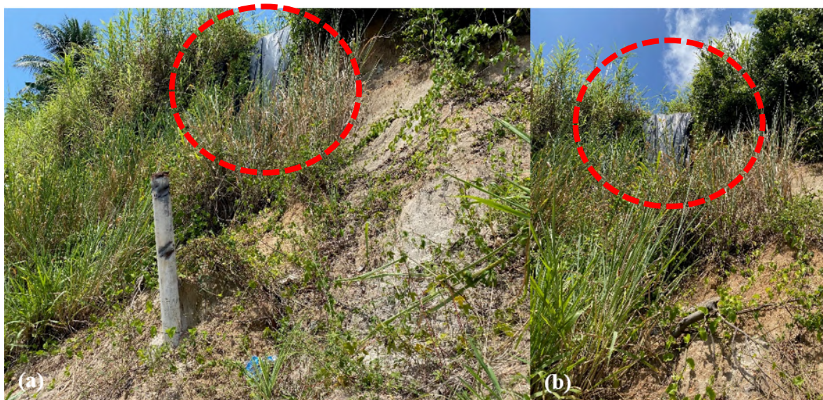
Figura 57 - Resquícios da lona plástica instalada em períodos chuvosos no talude da BR-230/PB
