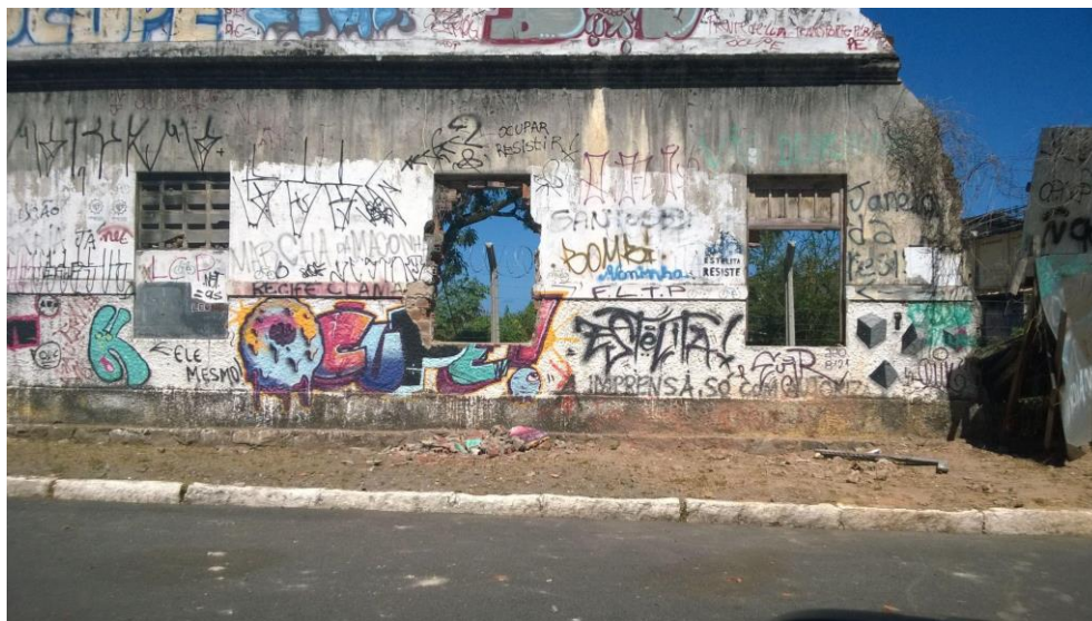
Figura 15 - Outros buracos foram abertos ao longo do muro do Cais José Estelita
