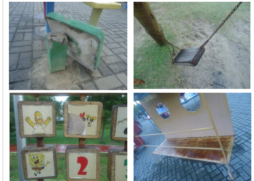
Figura 66: Degradação e oxidação do mobiliário urbano do parque
