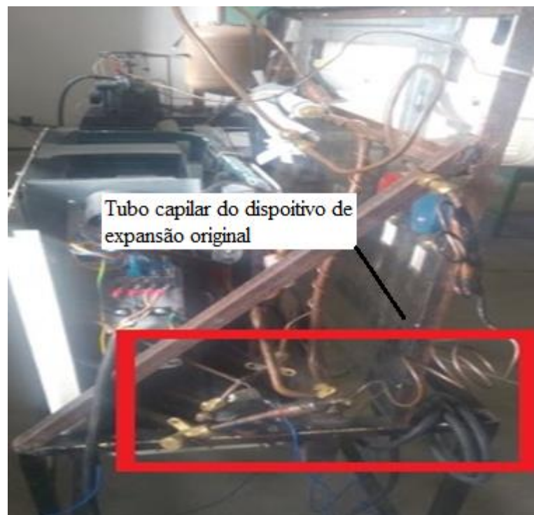
Figura 19 - Configuração original do sistema de refrigeração.
