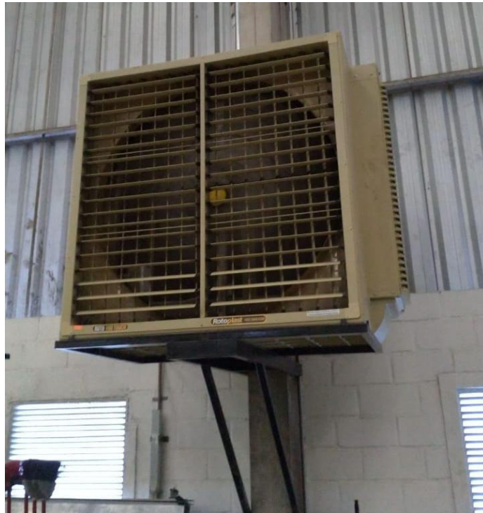
Figura 22: Climatizador instalado no setor
