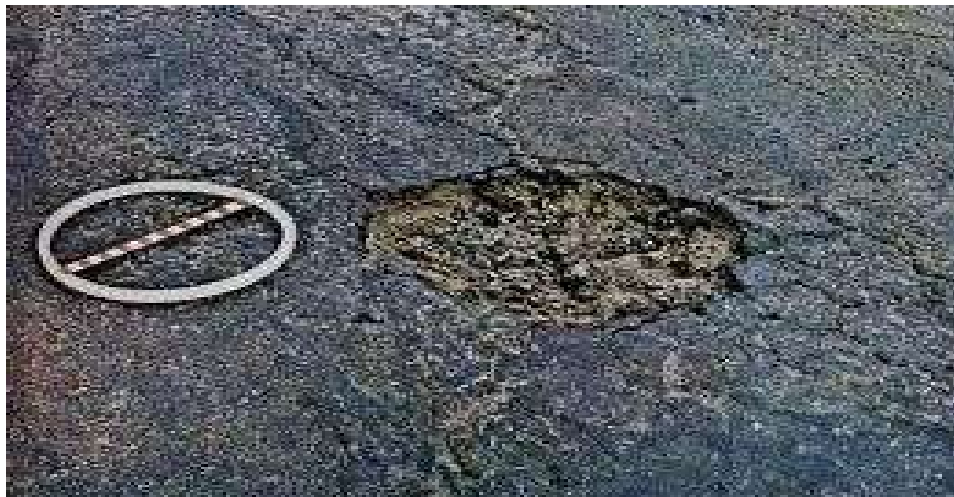
Figura 12: Panelas ou buracos
