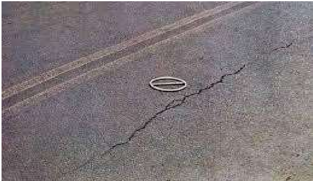
Figura 8: Trinca longitudinal Fonte: DNIT- Departamento Nacional de infraestrutura de transportes (2003 p 56).
