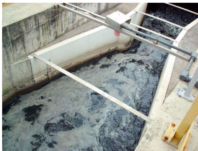
Figura 5 - Calha Parshall em operação
