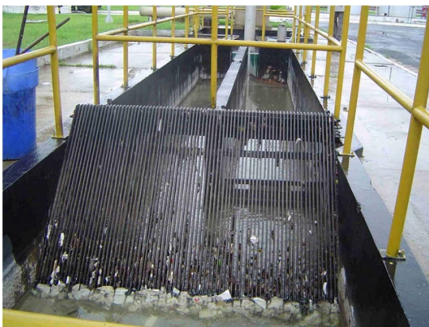
Figura 3 - Gradeamento utilizado na remoção de sólidos
