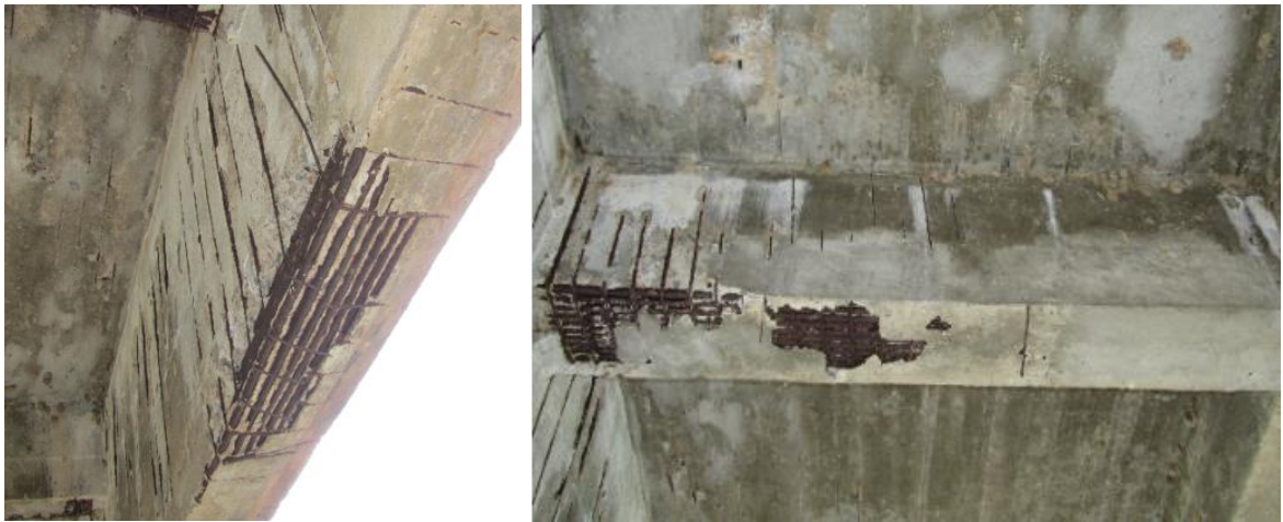
Figura 19 – Danos nas longarinas e transversinas
