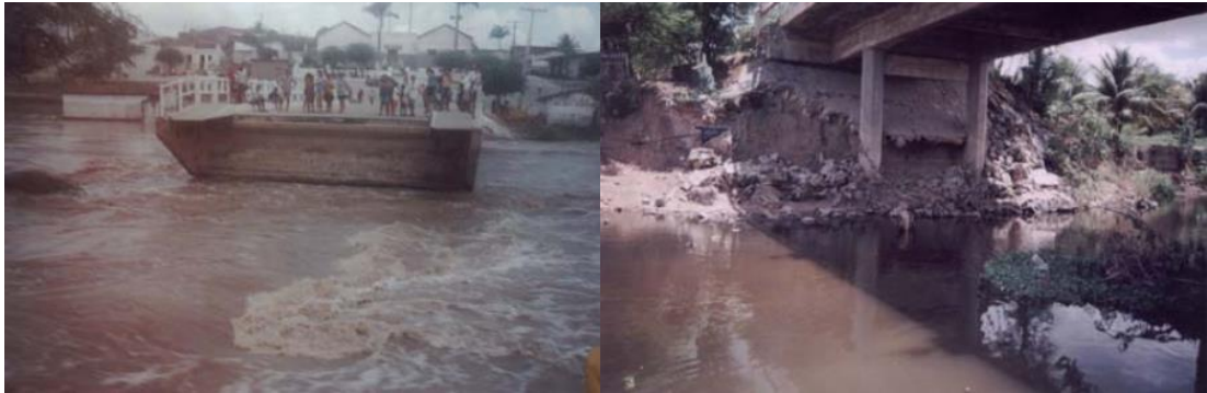
Figura 3 – Colapsos devido a ação de enchente e erosão em Pernambuco
