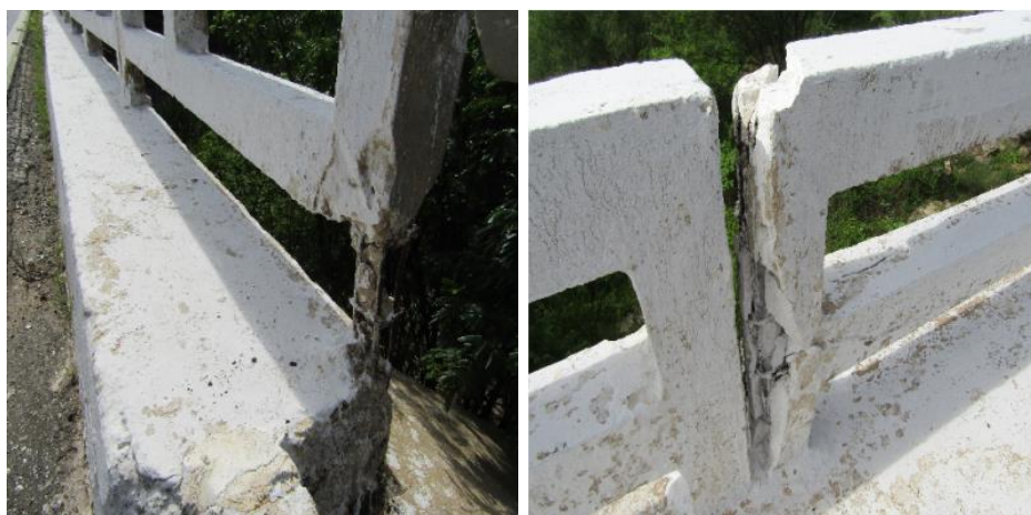
Figura 20 - Danos no guarda corpo
