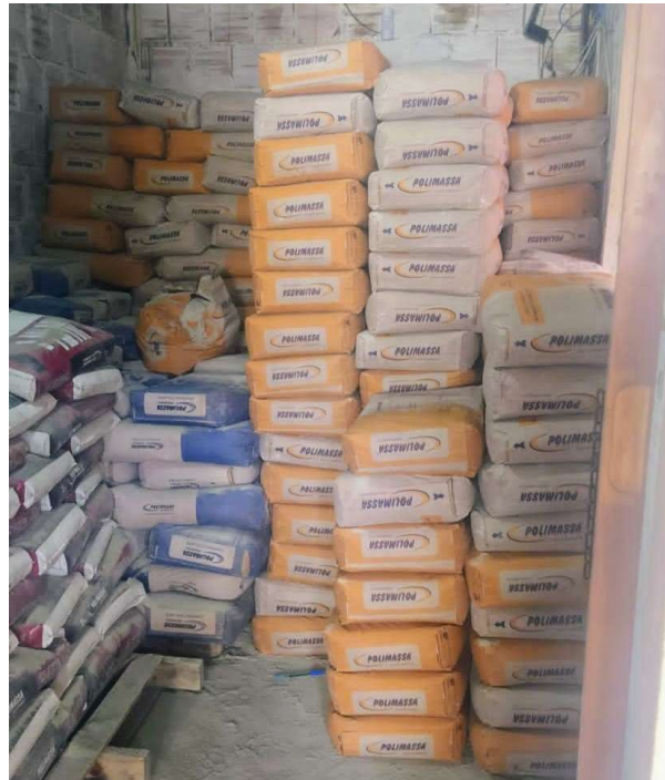
Figura 3 - Estoque de argamassas industrializadas para assentamento de alvenaria em almoxarifado próprio
