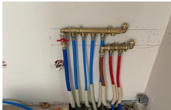
Imagem 9 – Alimentador de água fria e quente
