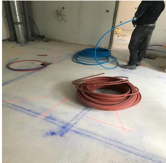
Imagem 10 – Passagem das tubulações de água fria e quente
