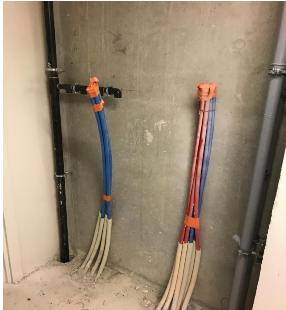
Imagem 8 – Colunas de água fria e calefação
