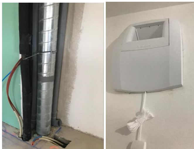
Imagem 11 – Sistema de exaustão
