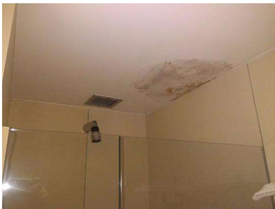
Figura 25 – Mancha de umidade em laje.
