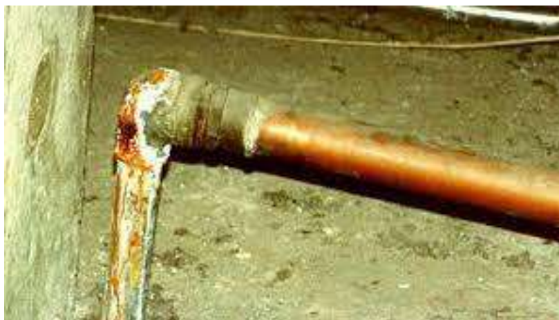
Figura 29 – Corrosão em tubulação de cobre.
