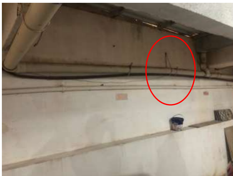
Figura 30 – Declividade em tubulação sanitária.
