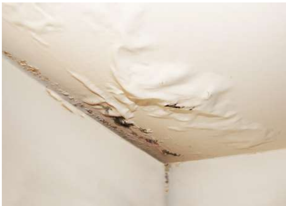
Figura 26 – Infiltração em laje de concreto.
