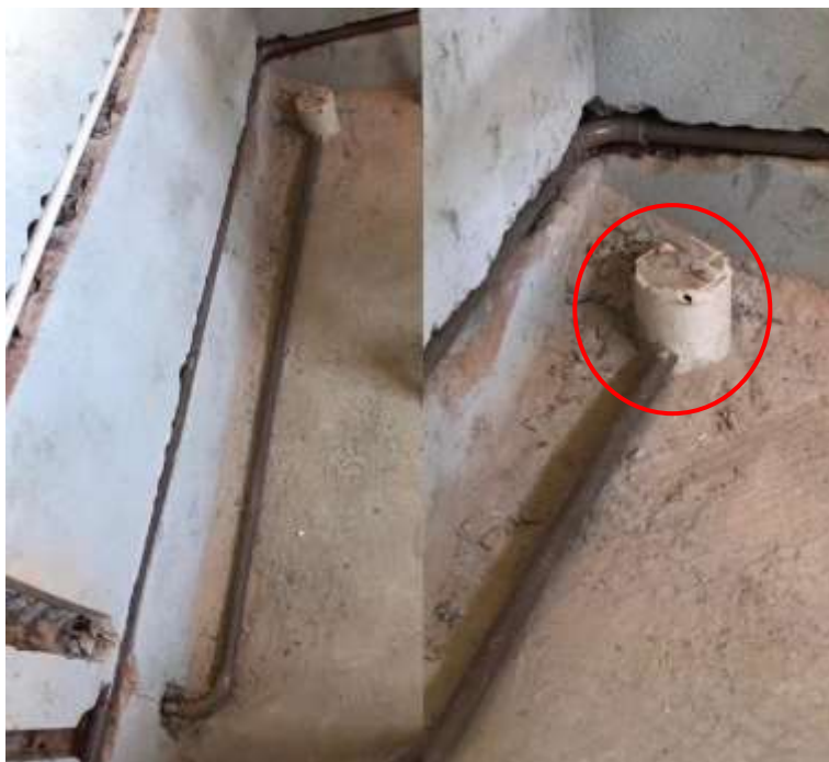
Figura 33 – Ligação da tubulação de split.
