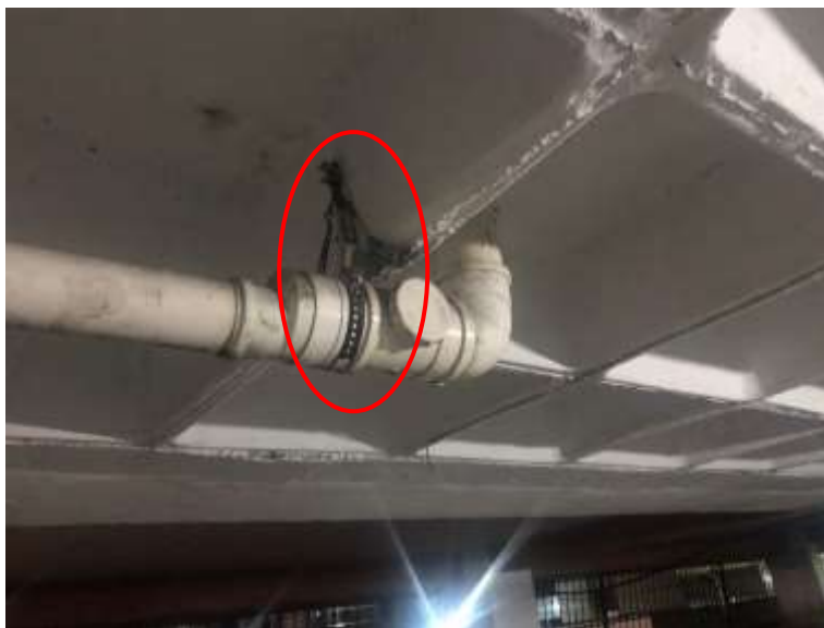
Figura 34 – Fita perfurada danificada.
