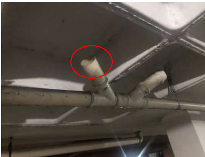
Figura 32 – Falta do CAP no final da tubulação.
