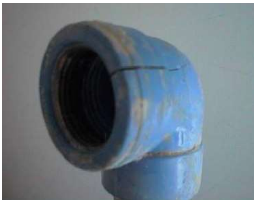
Figura 27 – Conexão trincada por aperto demasiado.
