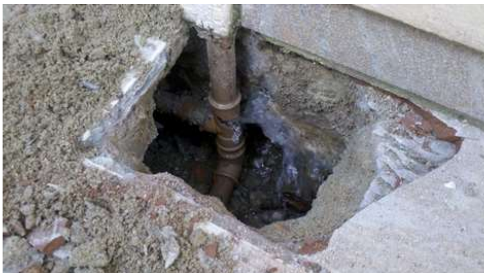
Figura 24 – Vazamento em conexão.
