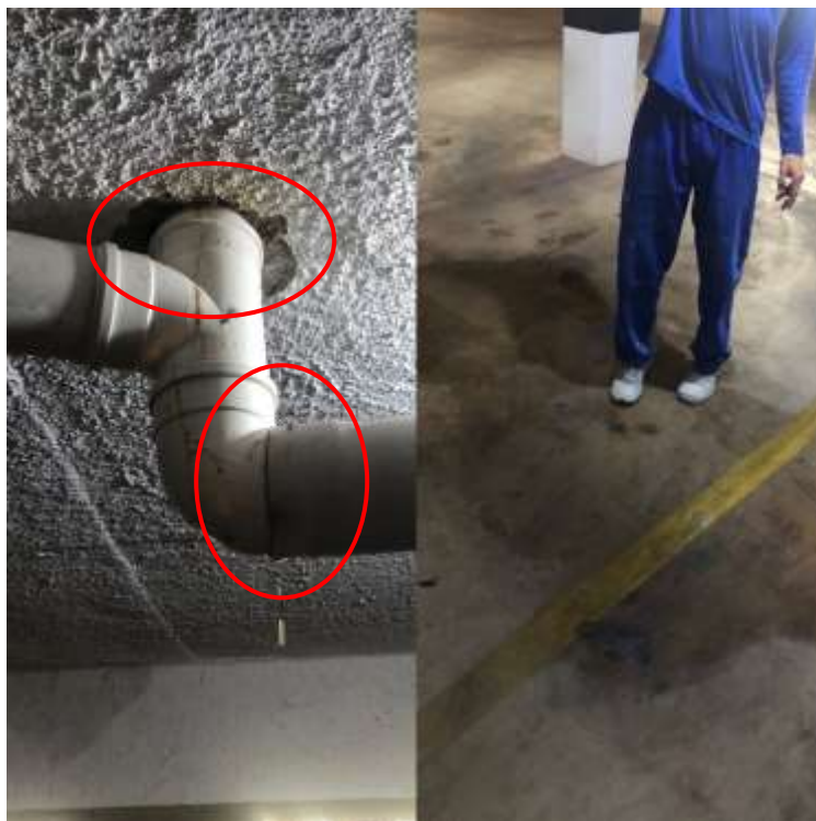
Figura 31 – Vazamento em ralo no deck da piscina.
