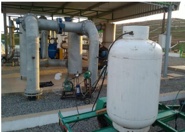
Figura 9. 1 – Sistema de captação e armazenamento de biogás instalado no aterro sanitário.
