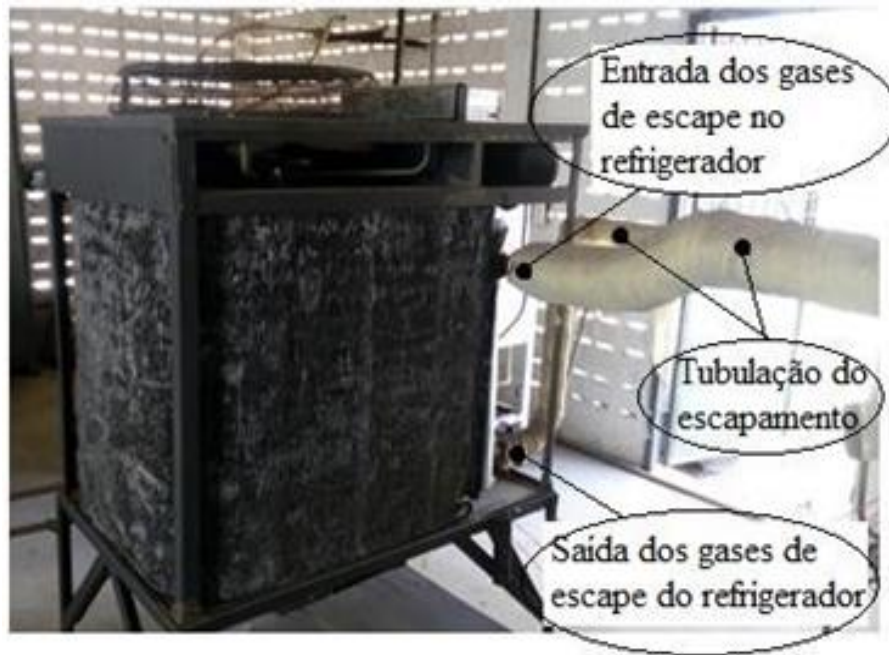
Figura 6. 5 – Refrigerador por absorção conectado ao escapamento do grupo gerador.
