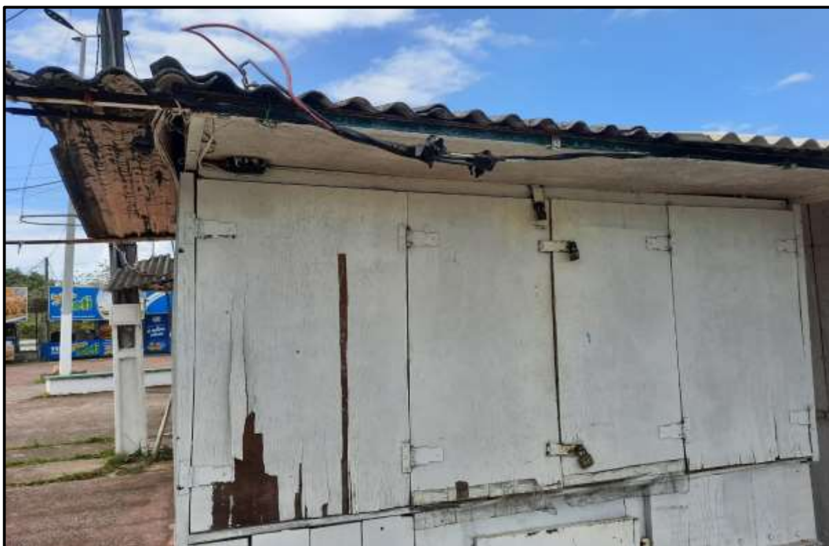
Figura 60: Precariedade das instalações elétricas das bancas de produtos artesanais da localidade mais afastada do centro do Parque Jacaré
