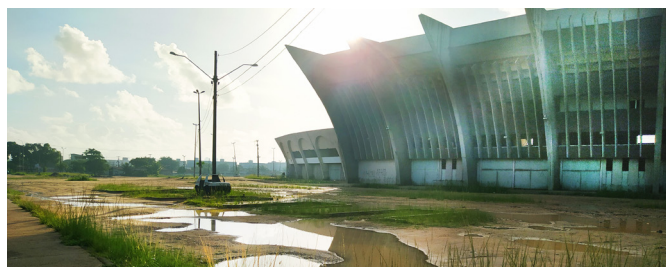
Figura 7 - Degradação da parte externa do Estádio. Fonte: Acervo da autora
