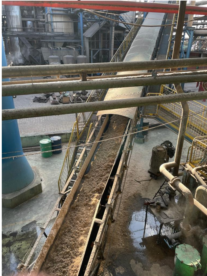
Figura 13 - Esteira da caldeira
