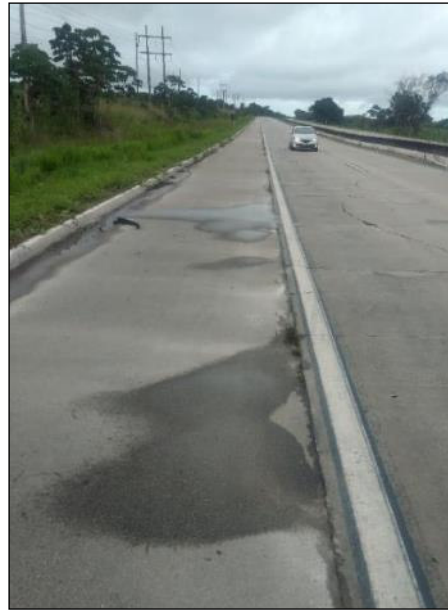
Figura 14 – Bombeamentos de finos na junta entre a pista e o acostamento.
