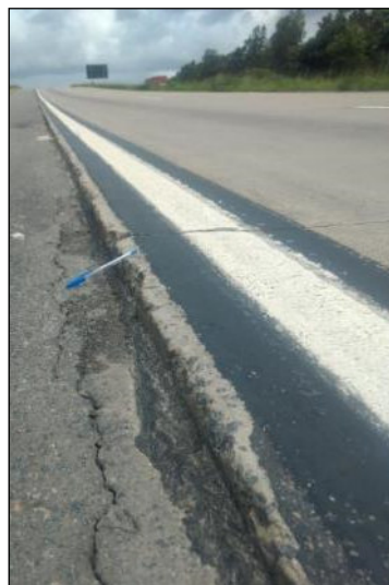
Figura 12 – Desnível entre acostamento e pista
