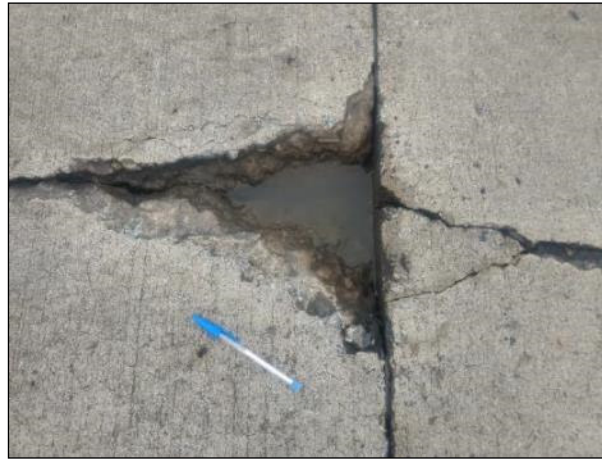
Figura 18 – buraco no pavimento.
