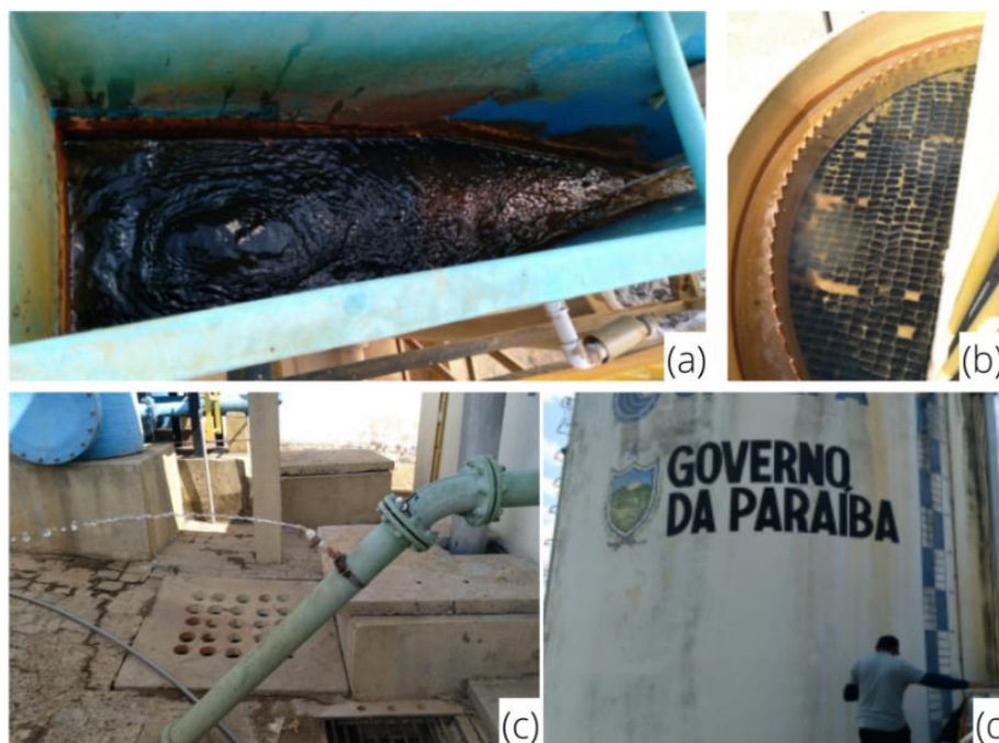
Figura 61 - ETA de Pedra Branca. (a) Água bruta; (b) Água decantada; (c) Água tratada (d) Caixa d'água.
