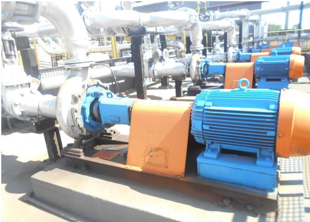
Figura 16-Praça de Bombas
