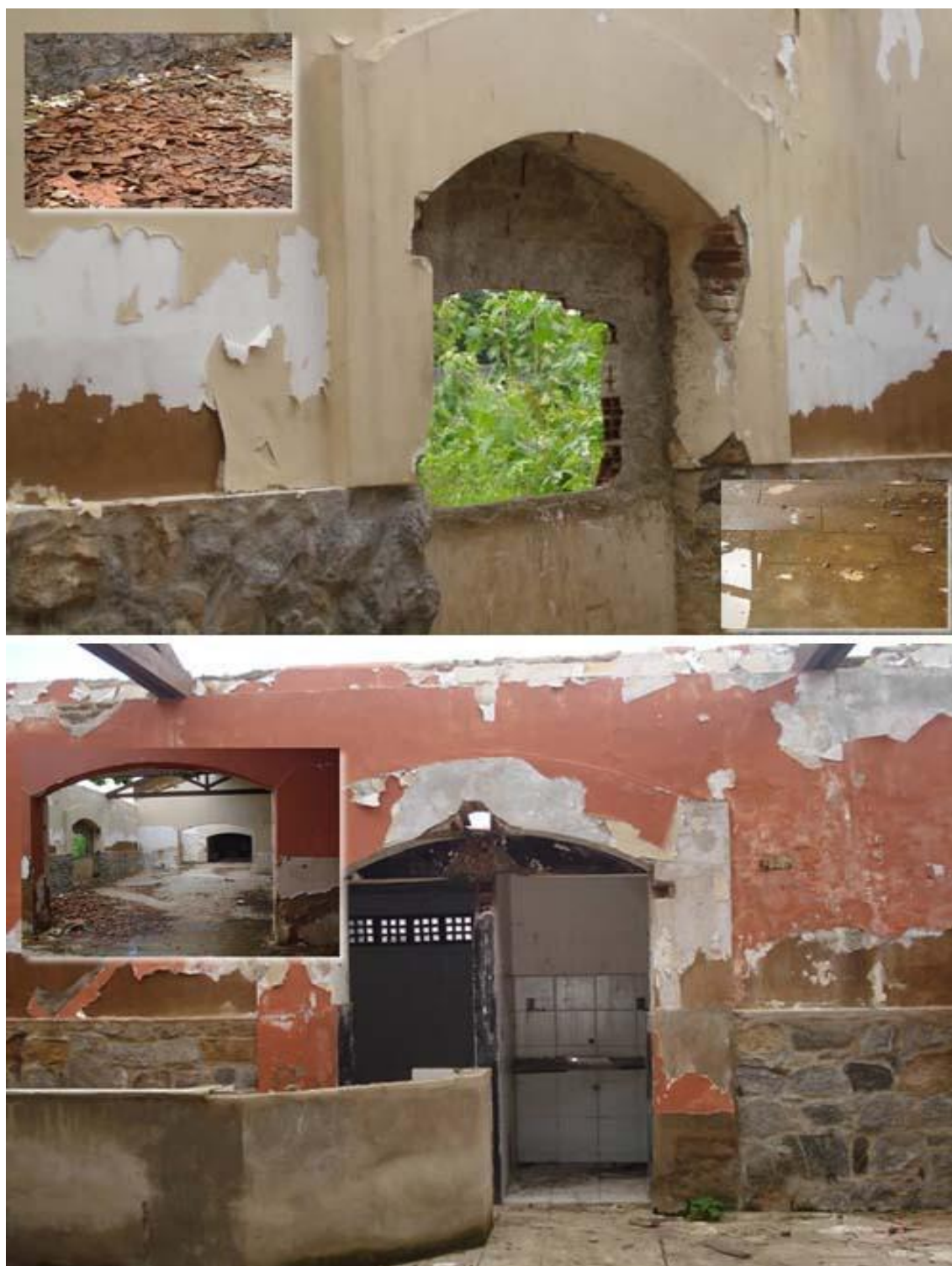
Figura 68 - Área interna da Estação Velha em estado de deterioração no início dos anos 2000.
