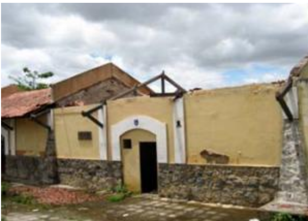
Figura 357 - Estação Velha em estado de deterioração no início dos anos 2000.
