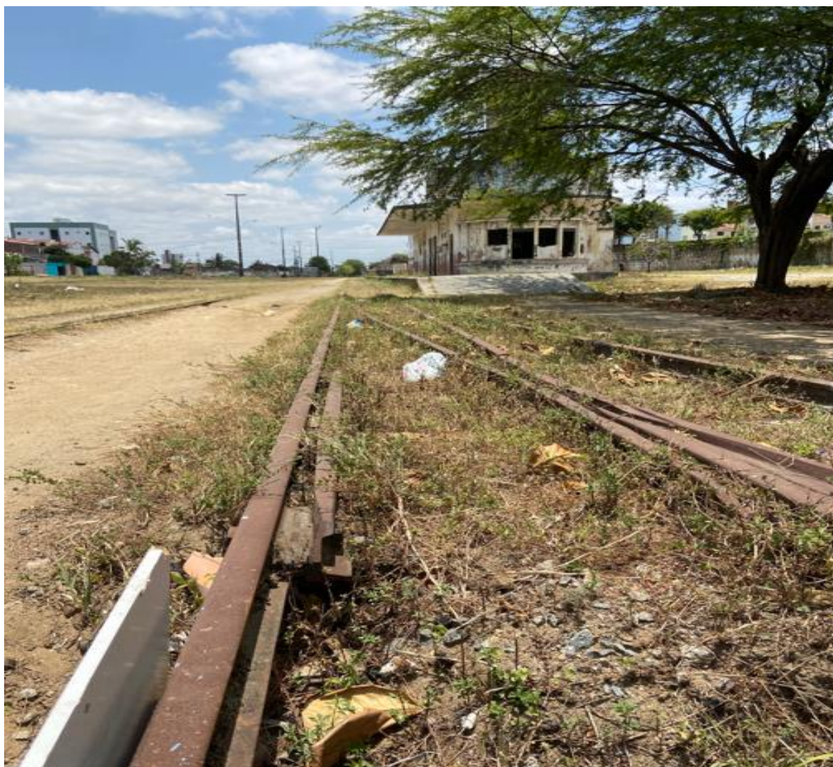
Figura 308 - Percurso comprometido e trilhos sucateados.
