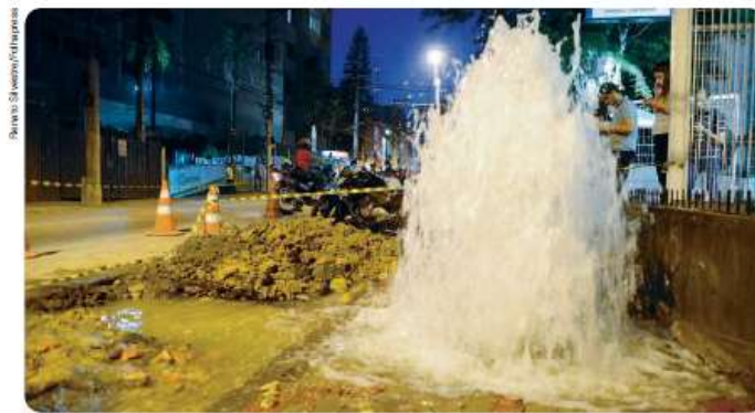
Vazamento de água na rua no município de São Paulo, no estado de São Paulo, em 2015.
