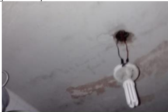
Imagem 54 - Fiação elétrica da Escola Estadual Belém Câmara
