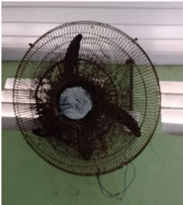
Imagem 62 - Ventiladores das salas de aula da Escola Estadual Belém Câmara
