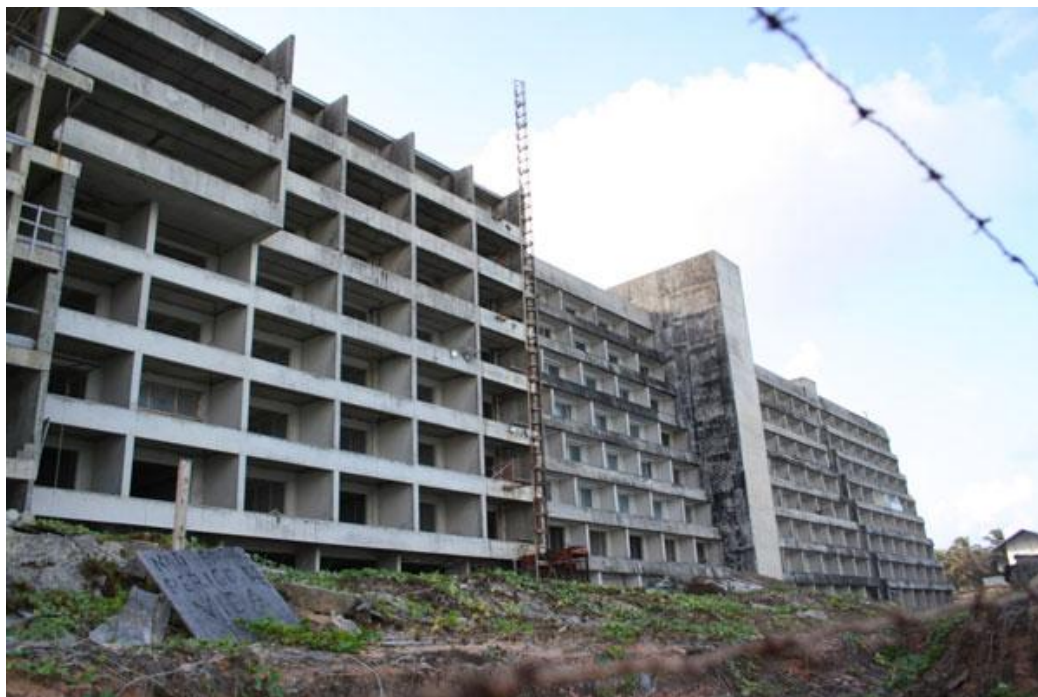
Figura 4 – Fotografia da vista frontal da edificação do hotel da construtora NATHWF que possibilita a contagem dos oito pavimentos da edificação, o dobro do permitido na Lei da ZET-02. (Fonte: Jornal Tribuna do Norte, 2011)
