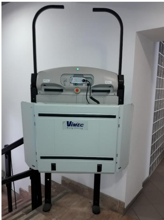
Figura 11: Plataforma elevatória para dar acessibilidade a cadeirantes na ROMATRE
