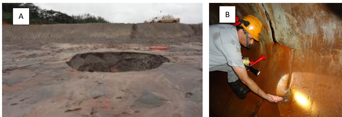
Figura 13 - Imagem da subsidência da galeria secundária (A) e da junta com vazamento (B). Fonte: SAMARCO (2012) apud MPF (2016).
