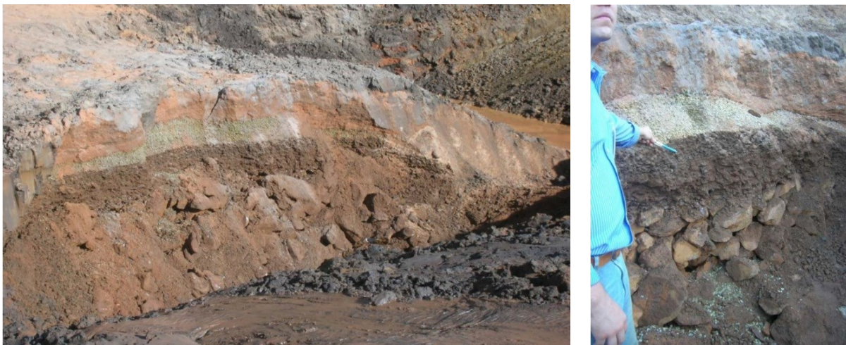
Figura 10 - Imagens da investigação dos drenos de fundo no talude de montante em 20/08/2009, constatando inconformidades nas camadas drenantes previstas em projeto, como espessuras a menor e até mesmo ausência de camadas. Fonte: SAMARCO (2009) apud MPF (2016).
