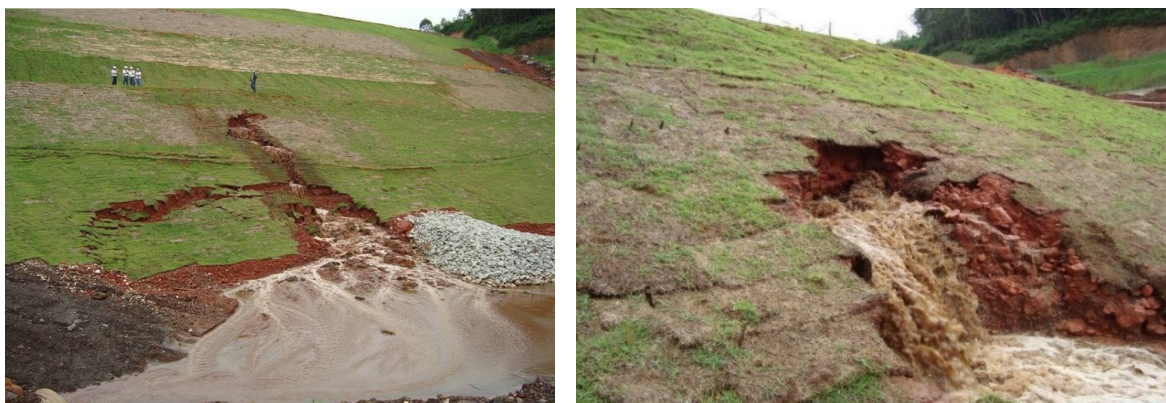
Figura 9 - Imagens do piping ocorrido em 13/04/2009 acima da saída do dreno de fundo. Fonte: SAMARCO (2009) apud MPF (2016).
