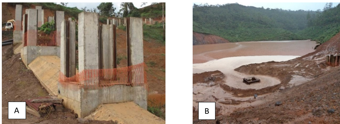
Figura 7 - Imagem das tulipas da galeria principal com marcos para receber os stop-logs 10 (A) e da tulipa da galeria secundária, quase em situação de bloqueio com stop-log (B) para elevação do nível d'água até a captação imediatamente superior 11 .
