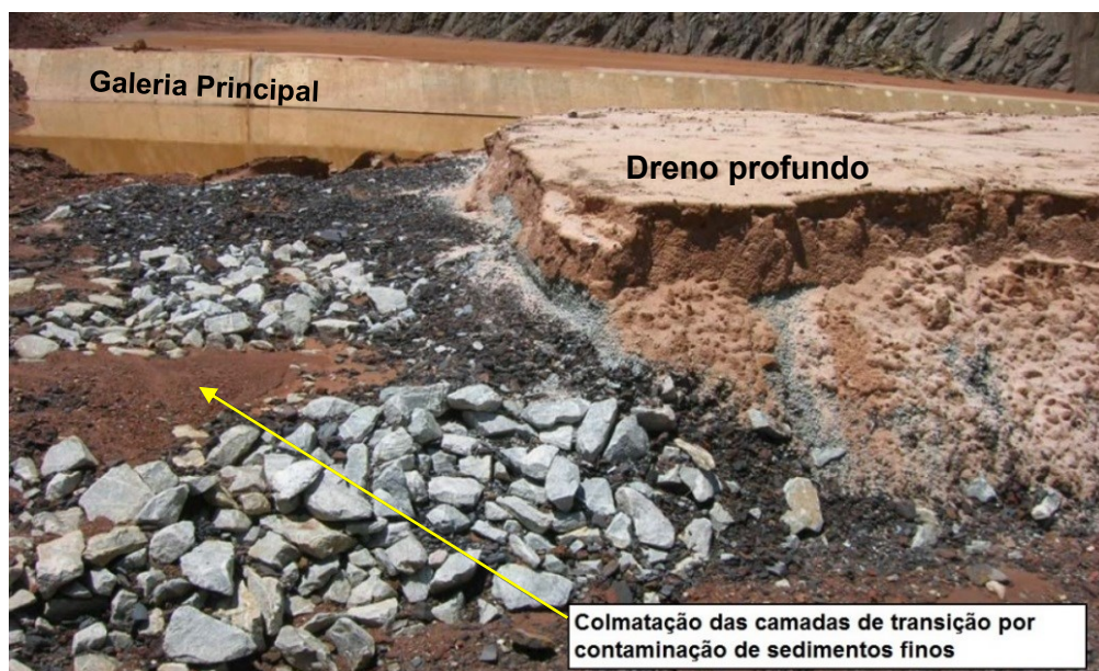
Figura 8 - Imagens de ângulos opostos da erosão do Dreno de Fundo Principal, junto ao cruzamento com o caminho de serviço, onde houve contaminação das camadas drenantes por sedimentos finos. Fonte: SAMARCO (2009) apud MPF (2016).
