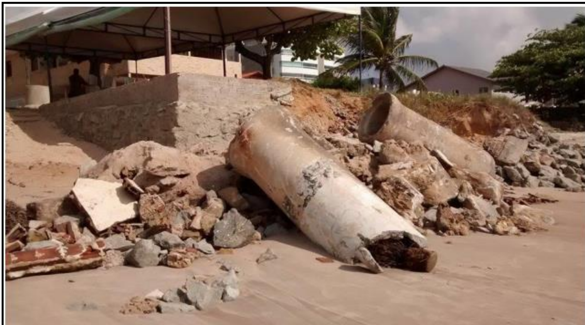
Figura 12: Contenção indevida dos moradores na Praia do Poço.
