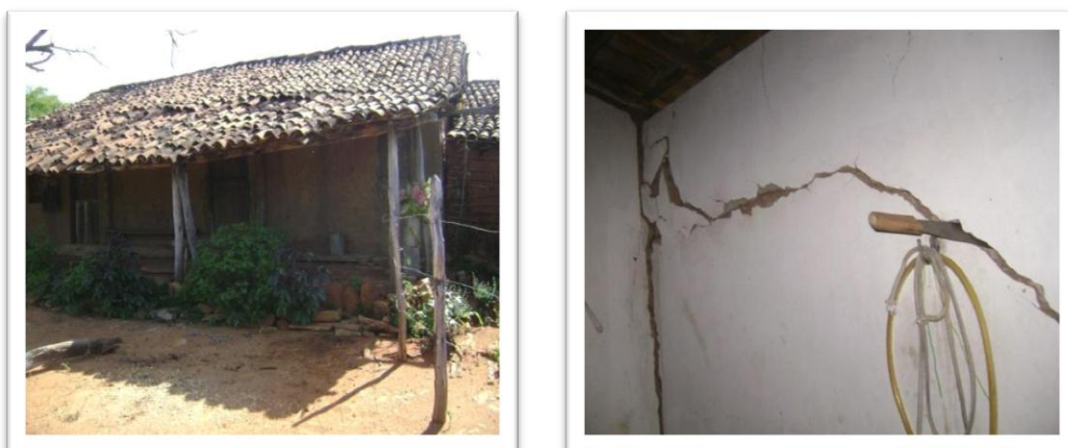
FIGURA 20 CASAS EM RISCO DE DESABAMENTO
