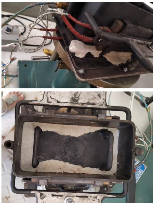
Figura 17 - Vazamento de polipropileno pelos cantos inferiores e pela tampa
