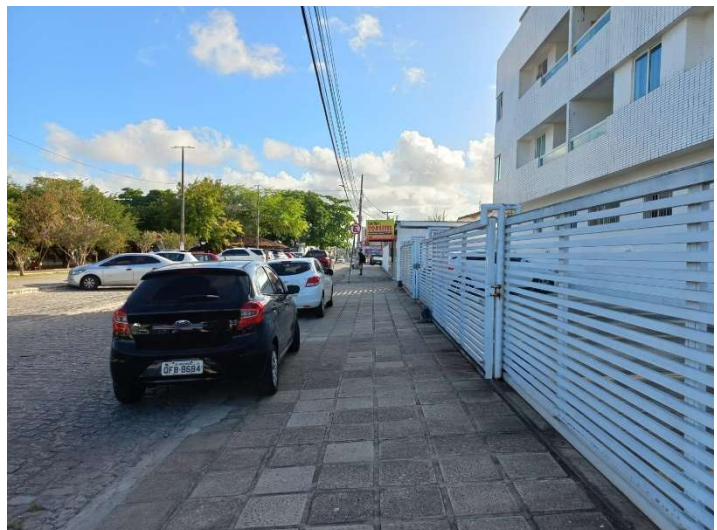
Figura 87: Calçada ocupada por carros no trecho 3
