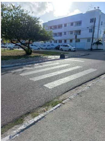
Figura 74: Faixa de pedestres desconectada de rota acessível e sem guias rebaixadas no trecho 2.
