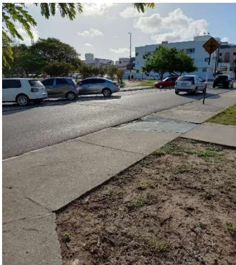
Figura 71: Calçada regular e rampa sem conexão com rota acessível no trecho 2.
