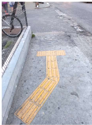
Figura 96: Piso Tátil desconectado.
