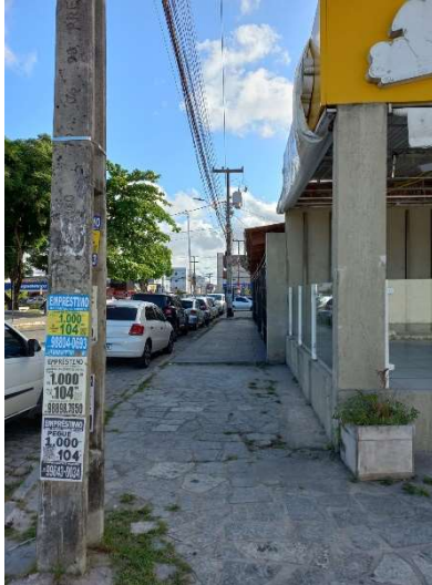
Figura 83: Calçada com desnível no trecho 3.
