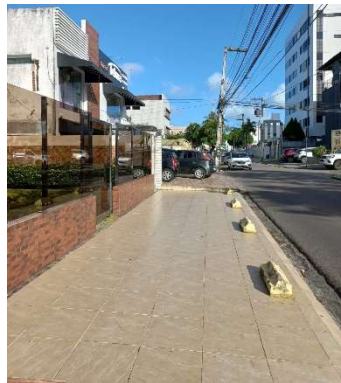
Figura 72: Calçada com desnível no trecho 2.
