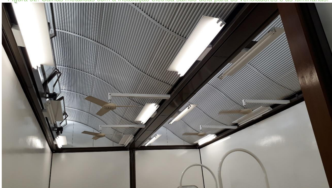
Figura 92: Calhas metálicas com a instalação elétrica saindo dela para os ventiladores e as luminárias.
