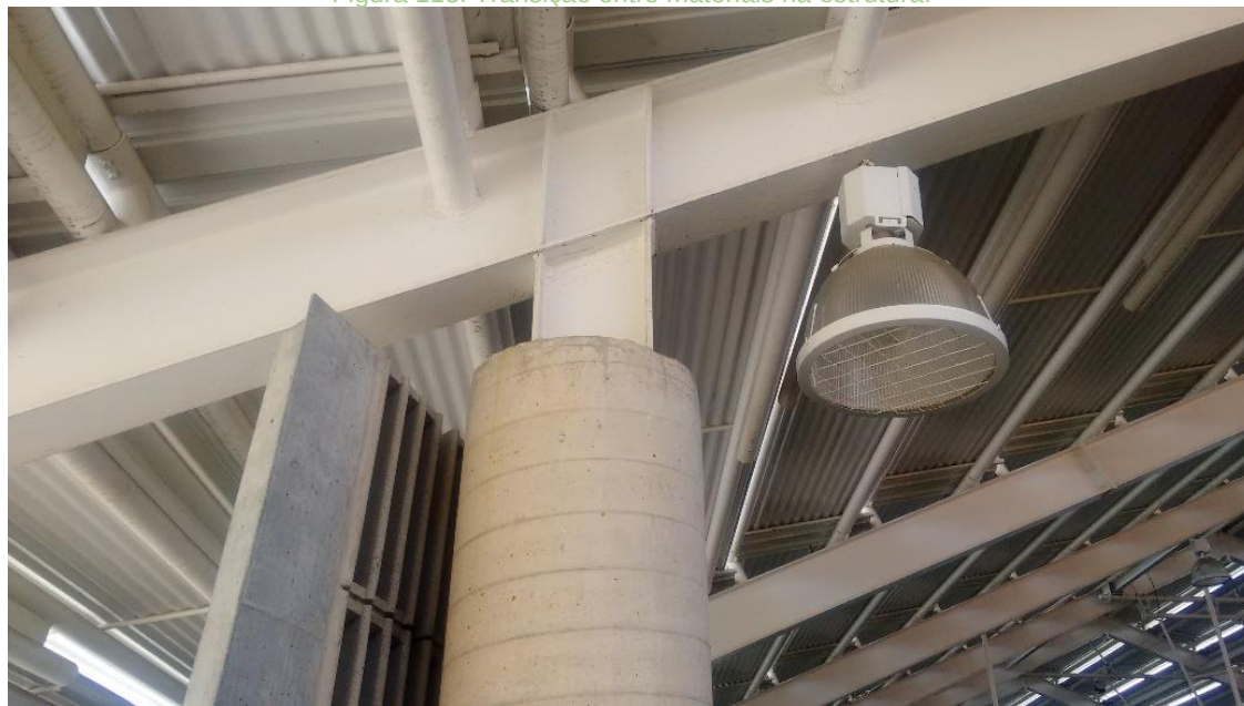
Figura 113: Transição entre materiais na estrutura.
