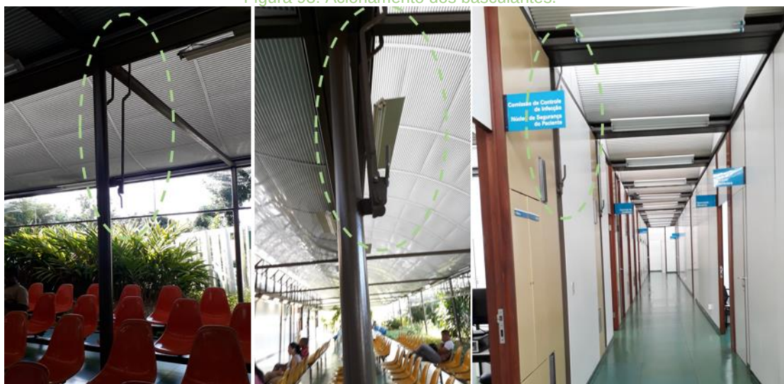
Figura 93: Acionamento dos basculantes.
