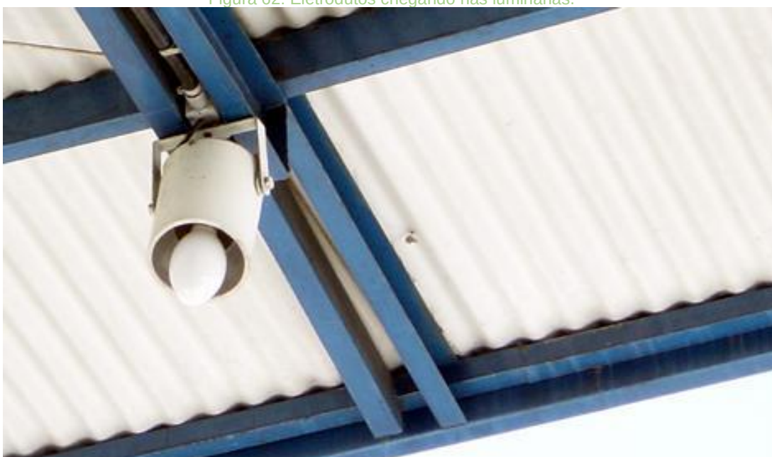
Figura 62: Eletrodutos chegando nas luminárias.
