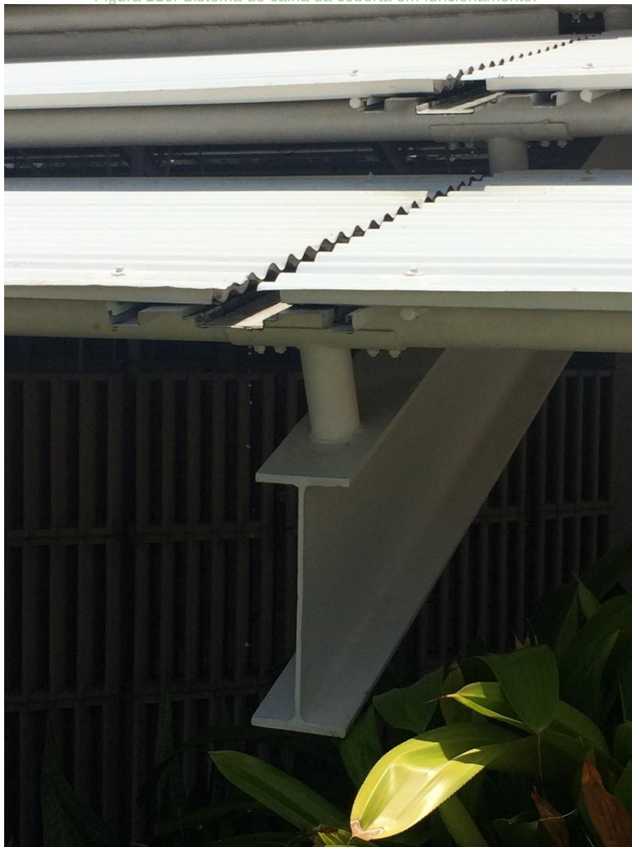
Figura 116: Sistema de calha da coberta em funcionamento.
