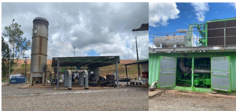
Figura 19 – Planta de recuperação energética do biogás no Aterro Sanitário Metropolitano de João Pessoa
